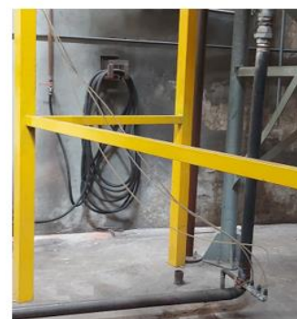
Tubulação da água (retorno)
