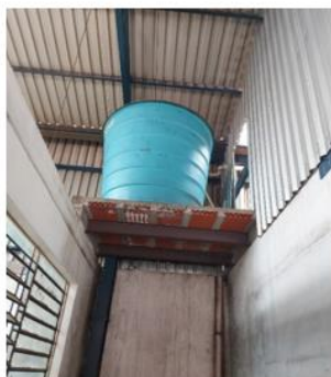
Caixa coletora da água da chuva
