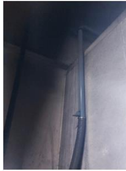
Tubulação para os filtros
